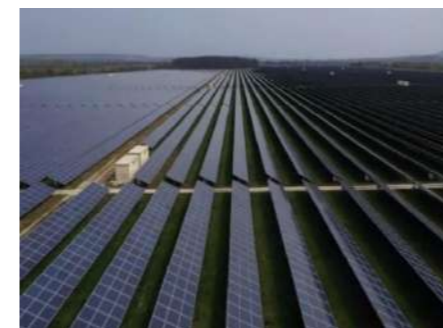
Photographie du parc photovoltaïque "Karad" - Bulgarie
